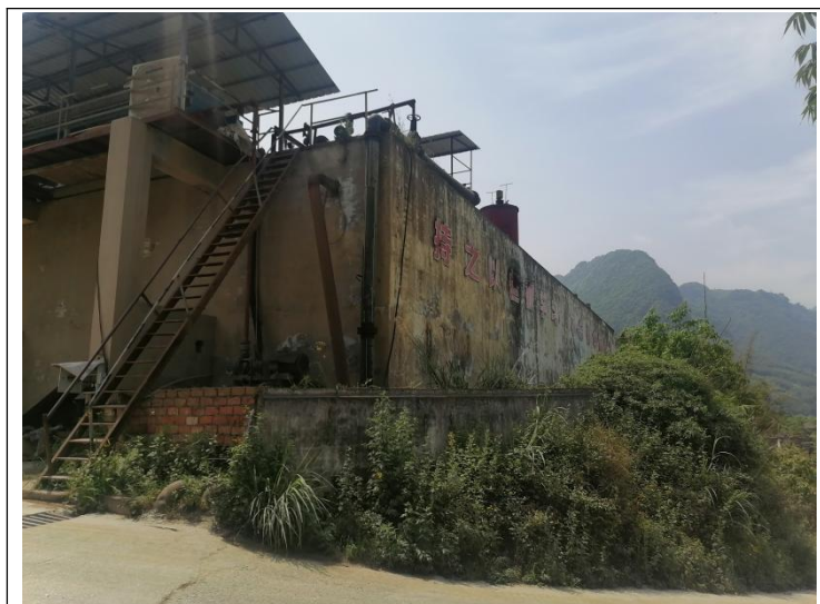
废水治理措施：沉淀池
