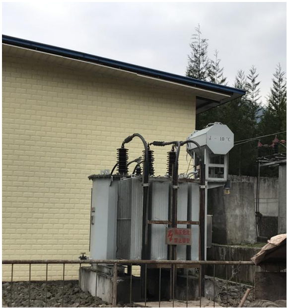
变压器及防渗措施
