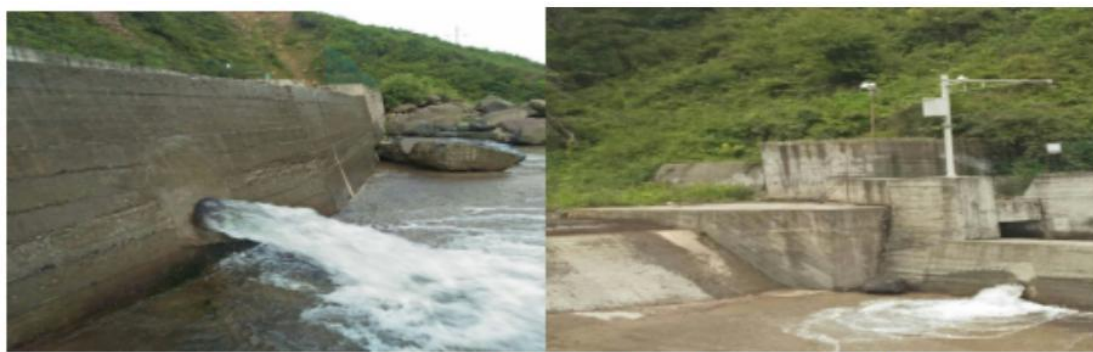
取水口下泄生态流量设施及在线监控照片
